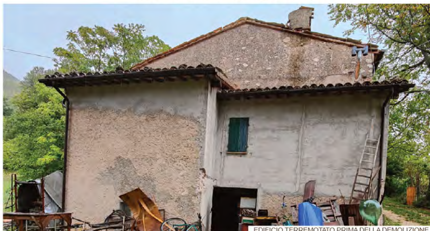
EDIFICIO TERREMOTATO PRIMA DELLA DEMOLIZIONE
